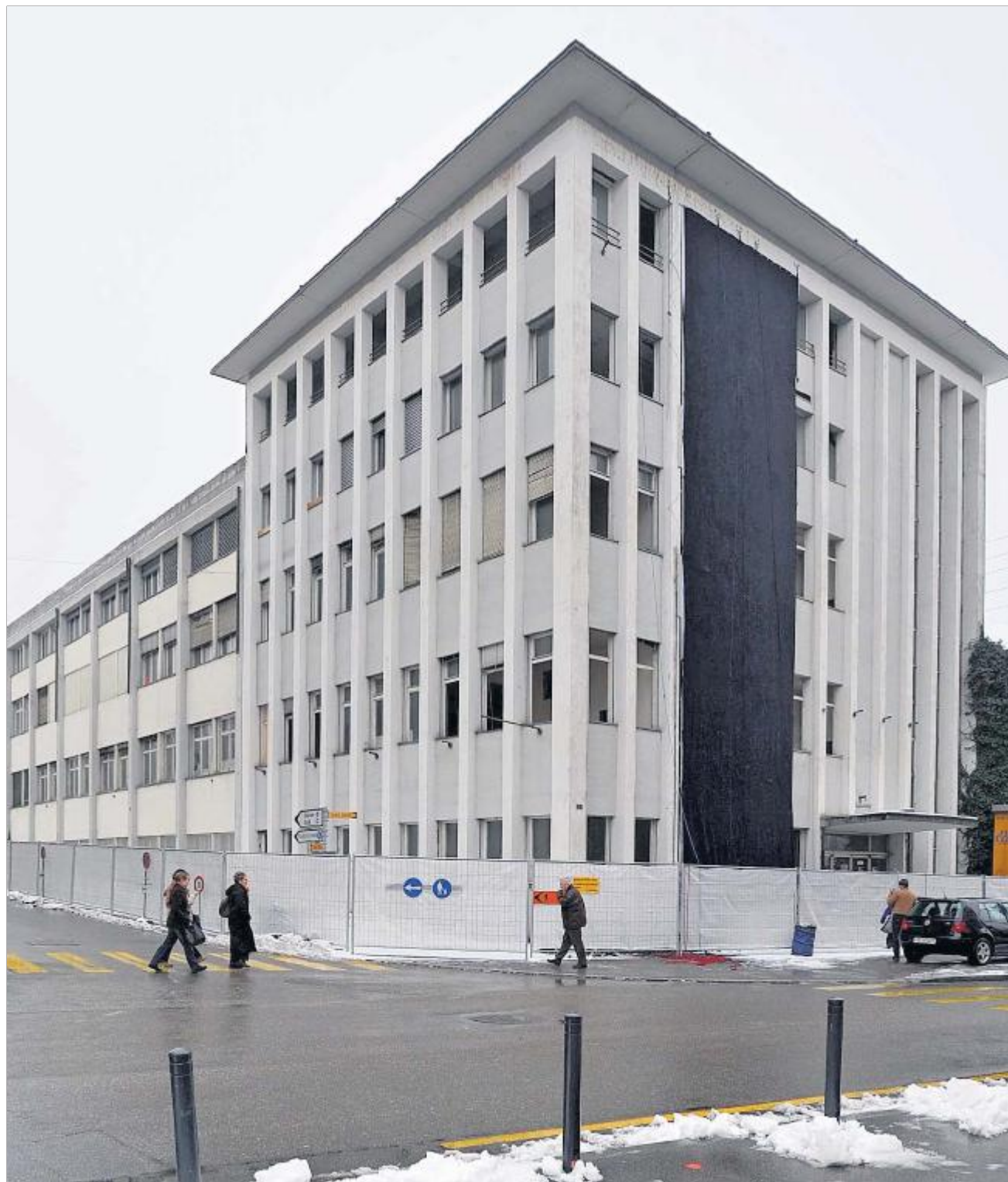
NOCH STEHEN SIE Die ehemaligen Zentralbetriebe der Coop Olten an der Tannwald-/Von-Roll-Strasse weichen dem FHNW-Neubau.
